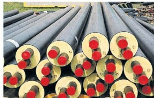
Nahwärmeleitungen liegen in Rauschenberg zum Einbau bereit. Doppelrohrige Leitungen haben einen besonders niedrigen Wärmeverlust.
