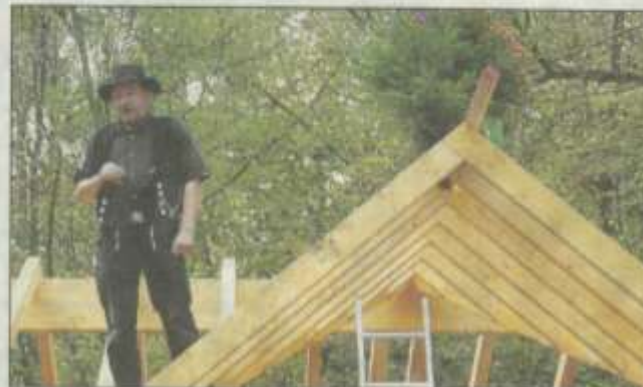
Er hatte das letzte Wort: Zimmermeister Jürgen Müller beim Richtspruch, verbunden mit guten Wünschen für das neue Haus.
