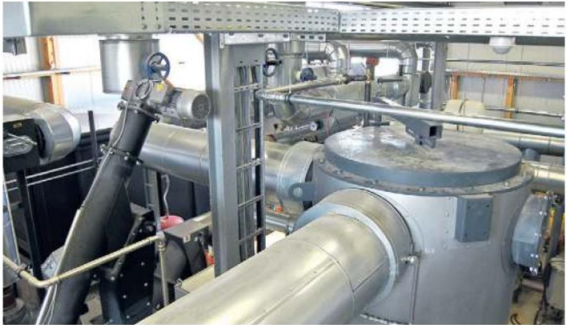
Heizzentrale mit Holzhackschnitzel-Ofen und Ölheizung: Wie in Erksdorf bei Stadallendorf soll dieser Energie-Mix schon in Laufe des nächsten Jahres die Gemündener Altstadt mit Energie versorgen. Archivfoto: Michael Rinde
