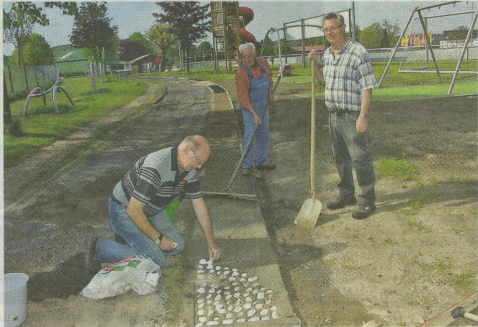
Die SVA-Vorstandsmitglieder Friedhelm Briel (hockend), Gert Anders und Manfred Arnold bei der Arbeit zur Fertigstellung des neuen Barfußpfads im Mehrgenerationenpark zwischen dem Stadion und dem Rasenplatz an der Beetwiese, im Hintergrund sind weitere Stationen des Mehrgenerationenparks zu sehen.
