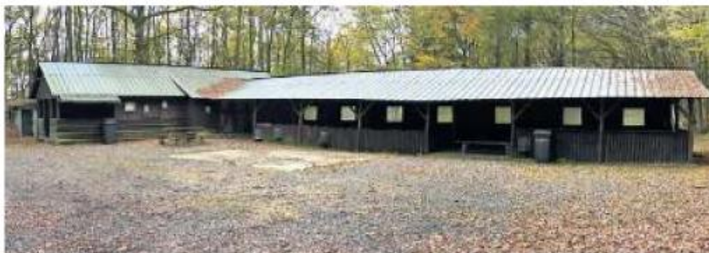
Die Grillhütte am Wildgehege war 1972 eröffnet worden und im Juni dieses Jahres abgebrannt. Ursache ist nach Polizeiangaben Brandstiftung, der Urheber wurde nicht ermittelt. Die Kosten für den Neubau werden auf 130 000 Euro geschätzt.
