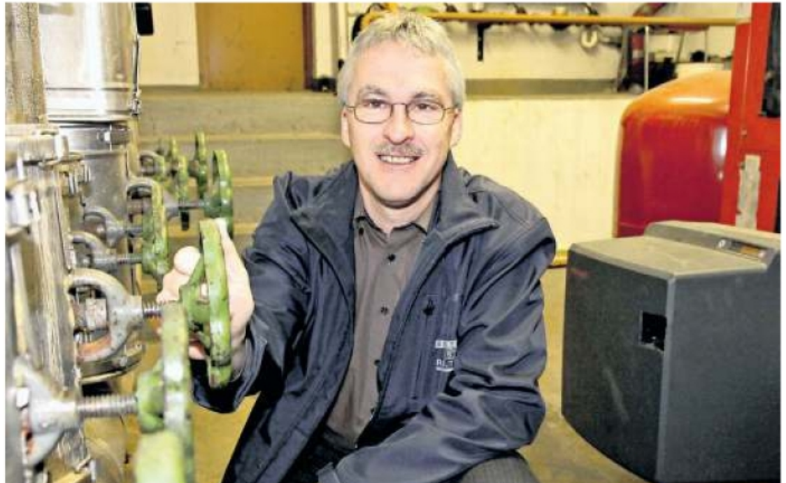
Die Heizungsanlagen der städtischen Liegenschaften müssen in den nächsten fünf bis zehn Jahren erneuert werden. Daher ist laut Bürgermeister Frank Gleim jetzt ein guter Zeitpunkt, über eine zentrale Wärmeversorgung für die öffentlichen Gebäude in Gemünden nachzudenken. Idealerweise würde die entsprechende Kesselanlage im Bürgerhaus stehen. Foto: Malte Glotz
