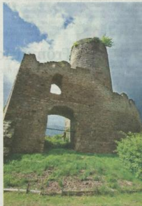
Der Turm der Mellnauer Burg muss saniert werden, weil sich an der Krone Steine lockern. Foto: Archiv
